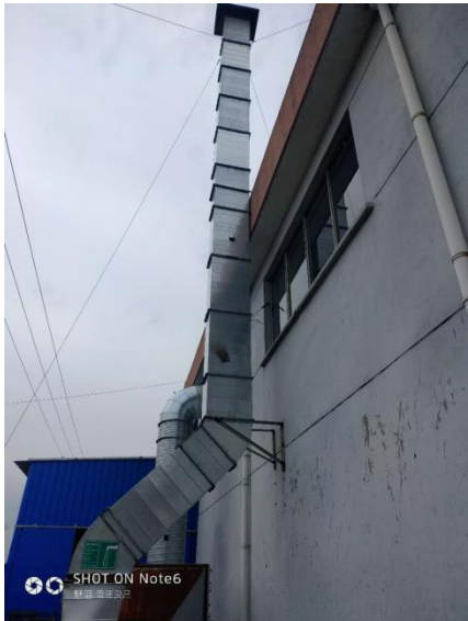
废气出口监测孔
