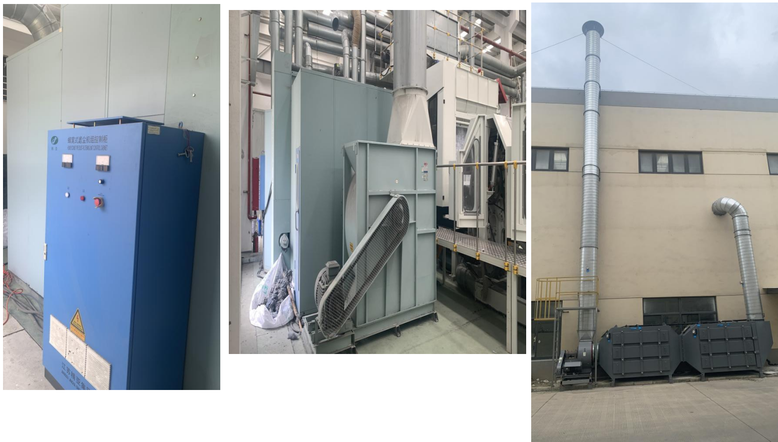
图 4-3 废气治理设施
