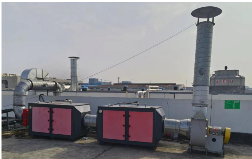
图 4-3 注塑废气治理设施
