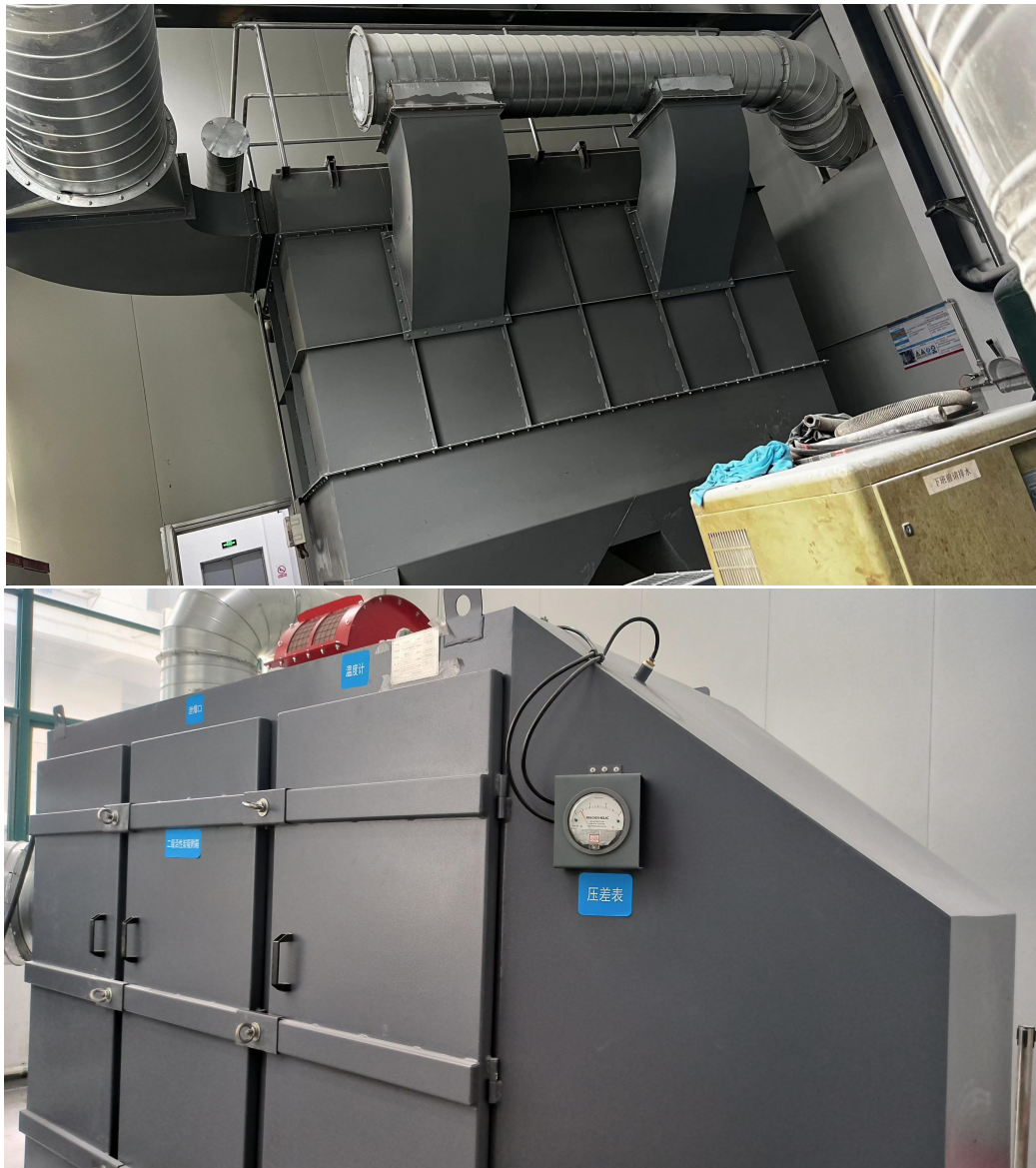
图 4-5 废气治理设施
