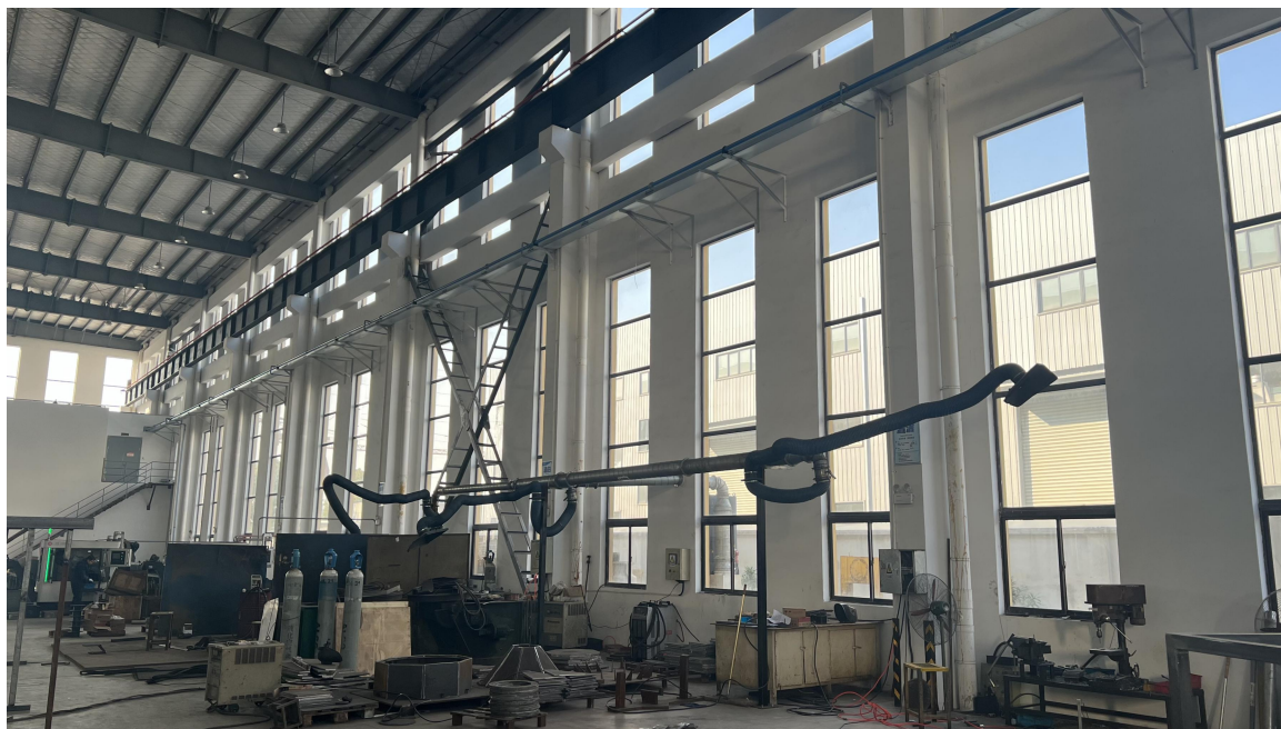
废气处理装置
