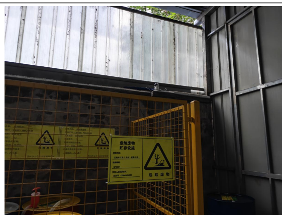
危废仓库内部视频监控
