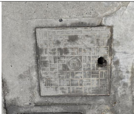
生活污水排放口
